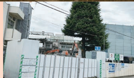
本格的な工事が始まり、病院本体の解体工事が始まりました。
